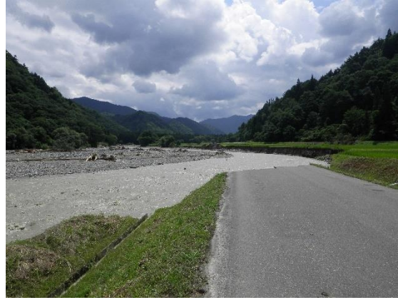
写真 2 黒谷地内 町道流出
