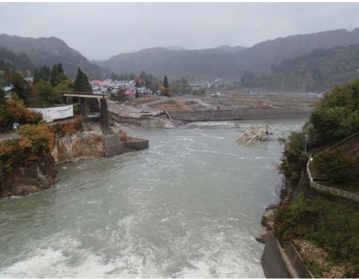
▲第6只見川橋梁(金山町)【橋げた流失】 (写真提供/会津ヨシ)
