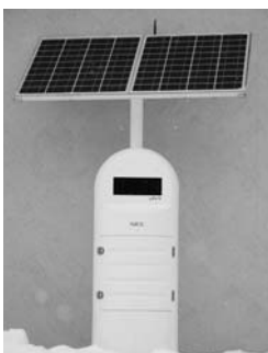
▲只見中に設置された測定機器
