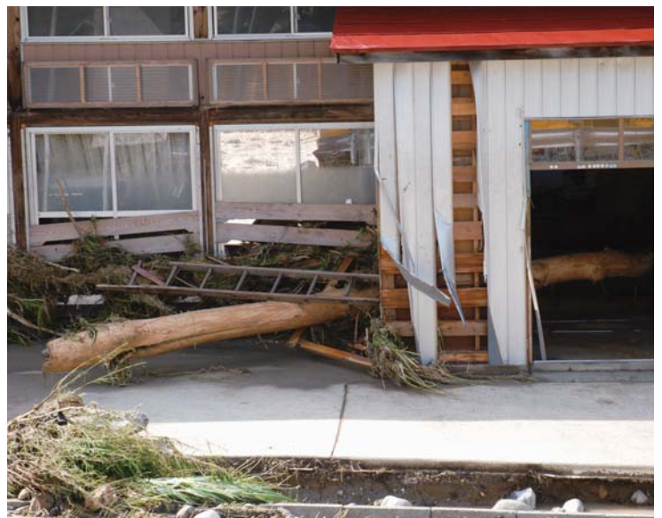
▲流木が玄関の壁に突き刺さった家屋(叶津地区)
