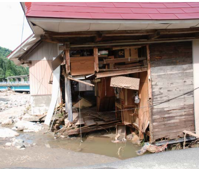
▲一階の一部が流失した家屋(叶津地区)
