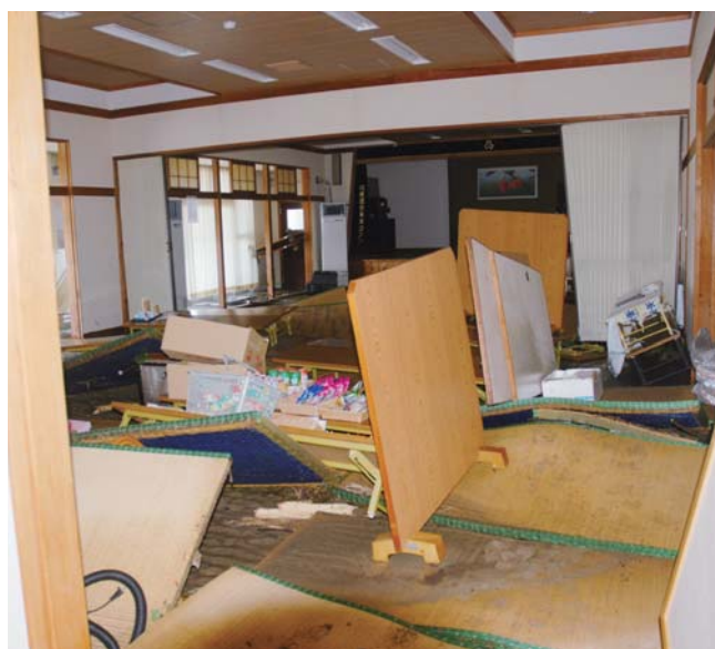
▲只見温泉保養センターも浸水(写真は大広間)
