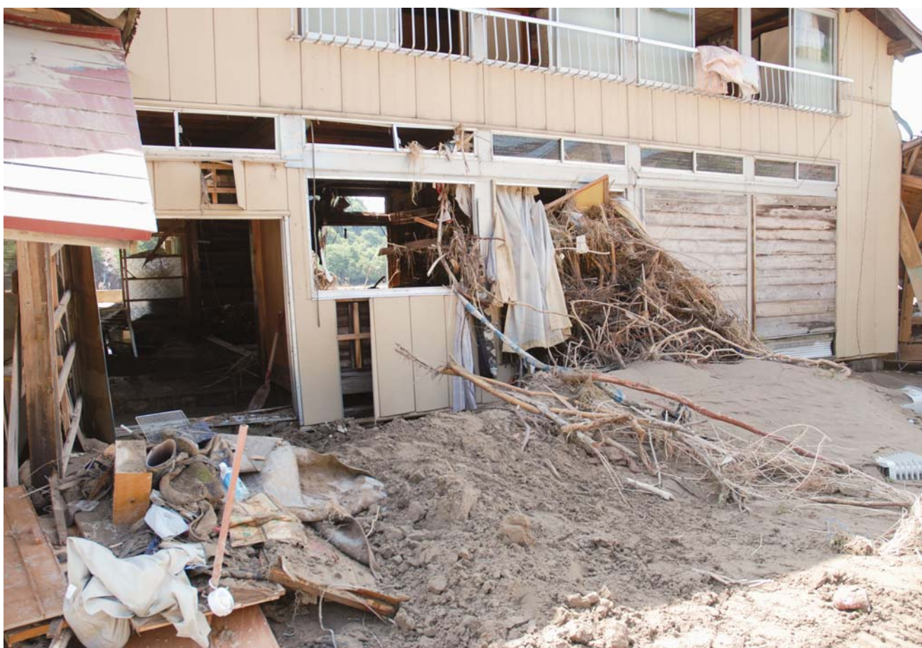
▲一階部分が、濁流に飲み込まれた家屋(八木沢地区)
