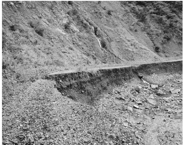
台風19号により被災した林道黒谷線
