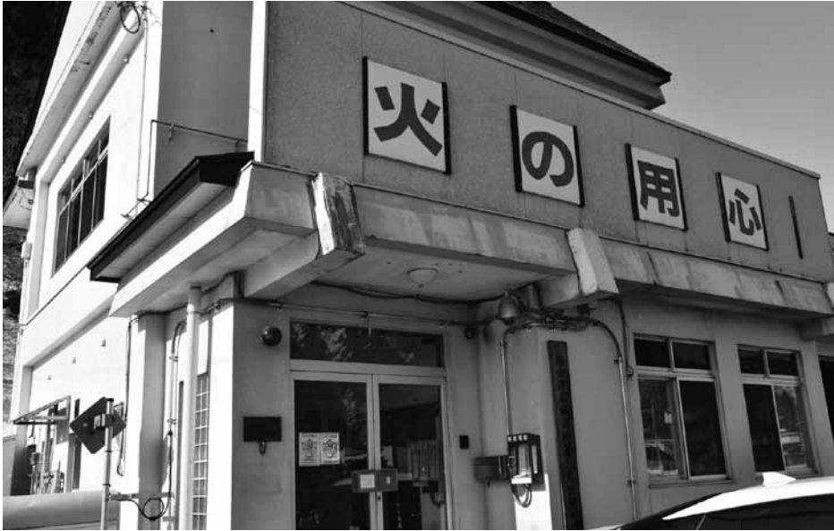
老朽化で建替えが必要な消防只見出張所
