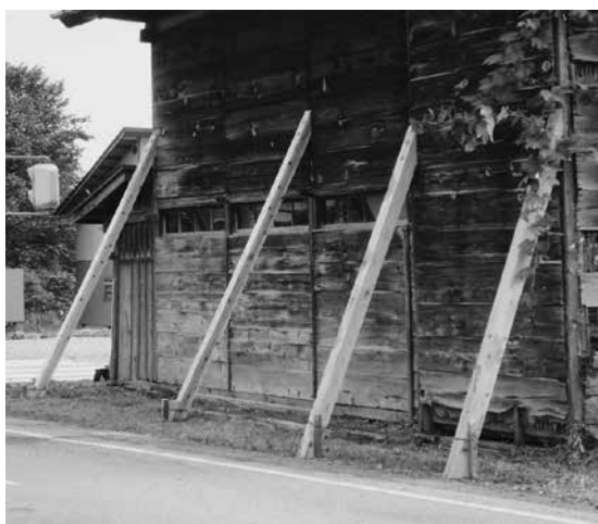
通学路上の危険空き家
