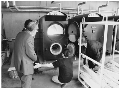
鮫川村「さざり荘」の薪ボイラー視察研修
