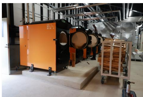
薪ボイラー施設
