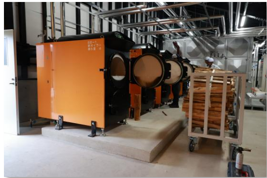
薪ボイラー施設
