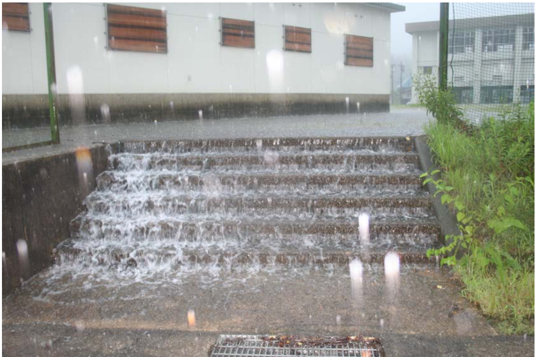
写真 4-5 旧只見中学校水害の状況 2
