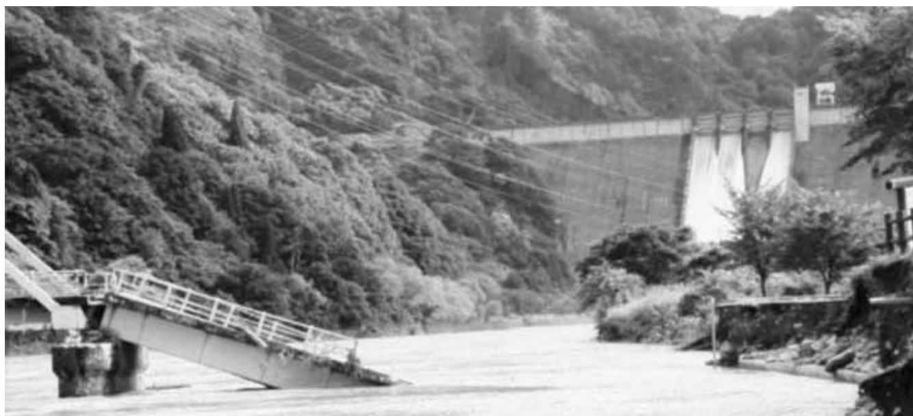
豪雨災害により落橋した万代橋の状況
