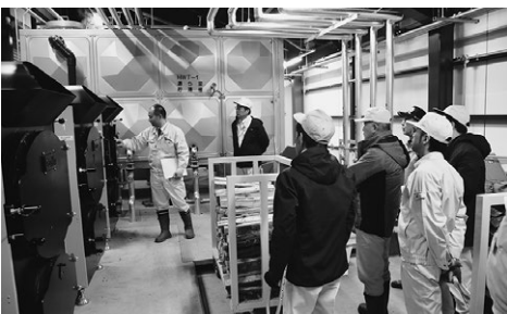
薪ボイラー施設内部
