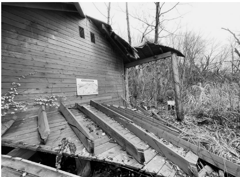
壊れたままの観光施設（ただみの森キャンプ場）
